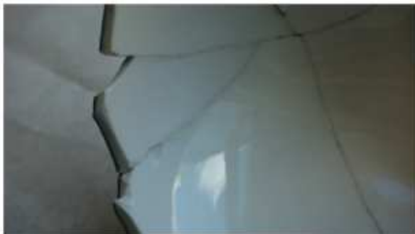
Abb.109: Transparentes hervorquellendes Klebemittel in den Fugen Objekt A8
