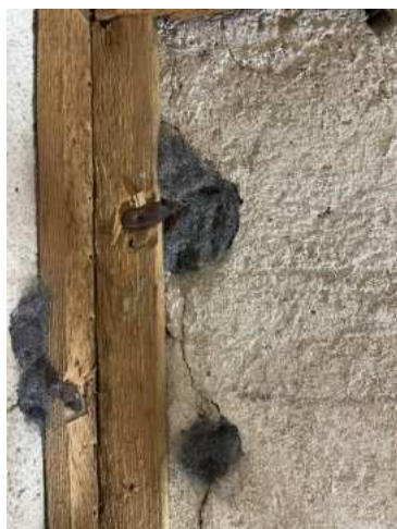
Abbildung 128: Mit Stahlwolle geschlossene Ausbrüche
