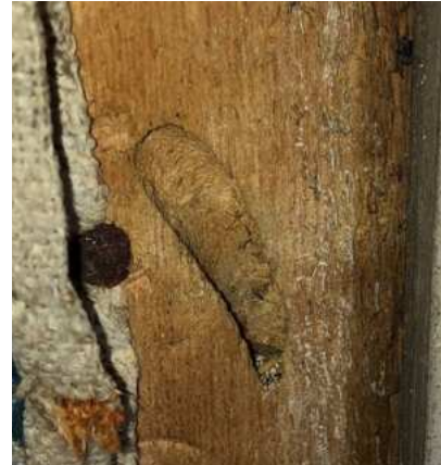
Abbildung 61: SZ/WW/WF1: Spur eines Holzschädlings in der rechten Blindleiste
