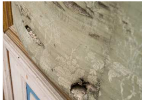
Abbildung 72: Prall gefüllte Schmutztaschen, die das Gewebe ausbeulen und bereits geschädigt haben (Löcher)
