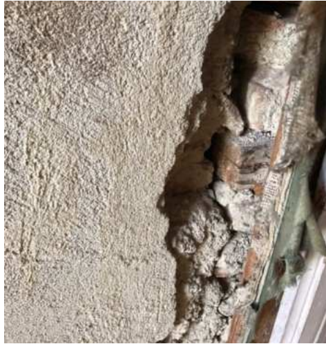
Abbildung 87: SZ/NW/WF1: Ausbrüche des Verputz
