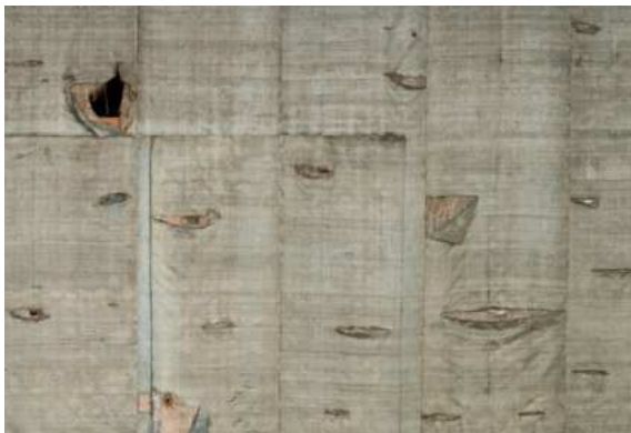
Abbildung 75: SZ/SW/WF1: Horizontal verlaufende Risse
