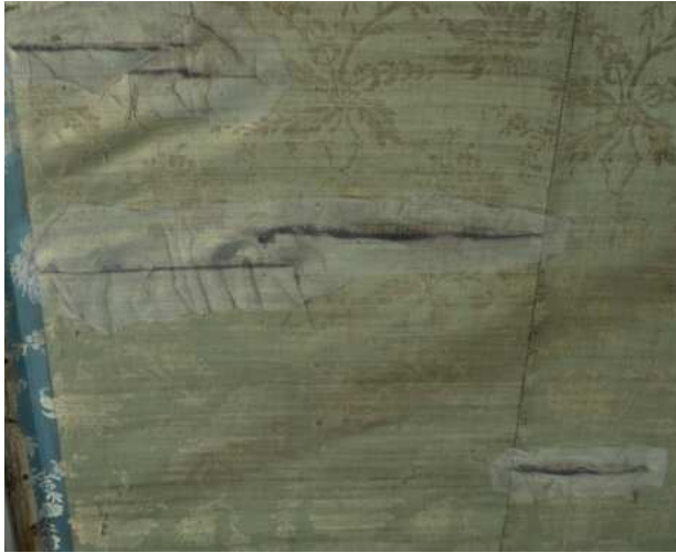
Abbildung 103: Notsicherung der Risse mit Tüll
