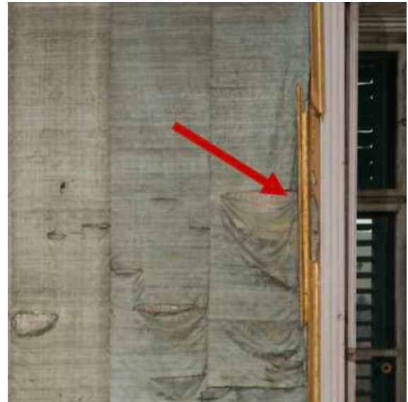
Abbildung 58: SZ/SW/WF1: Fehlerhafte Wiedermontage eines Zierleistenstücks
