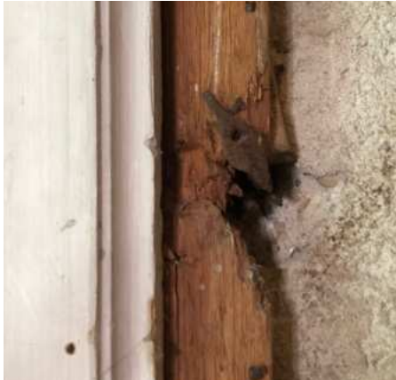
Abbildung 60: SZ/NW/WF2: Ausgebrochenes Stück einer Blindleiste
