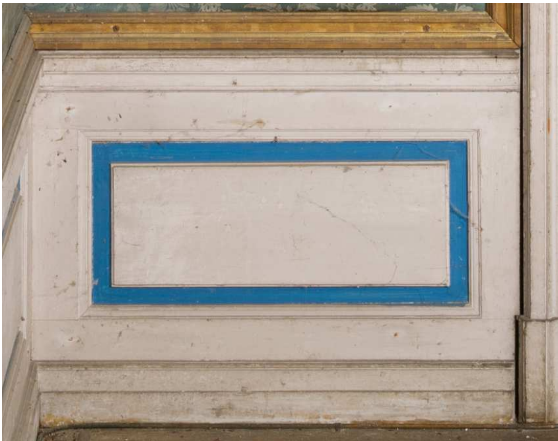
Abb. 162 Scherbenzimmer, Sockel, links neben linken Fenster Westseite
