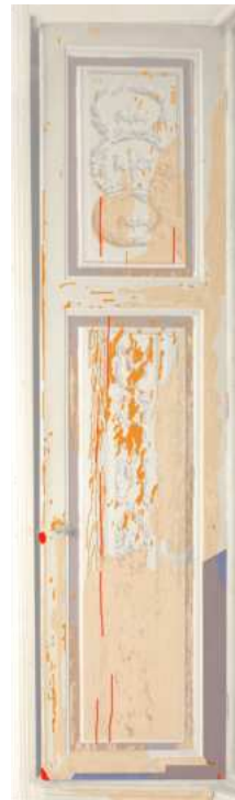
Abb. 80 Kartierung: Scherbenzimmer, Fenster Südseite, Fensterladen, Vorderseite, links
