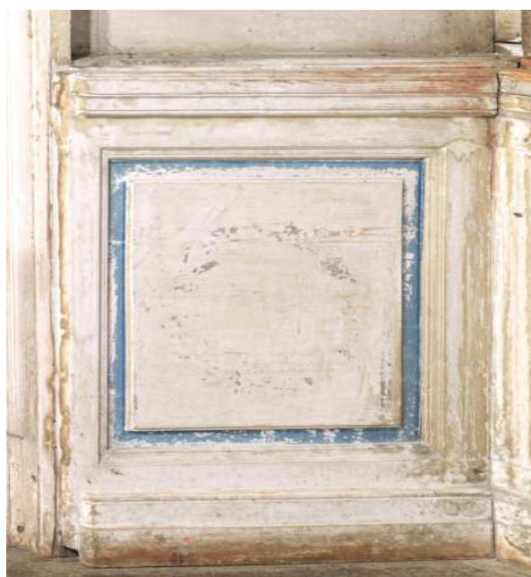
Abb. 141 Scherbenzimmer, rechtes Fenster Westseite, Sockel, links
