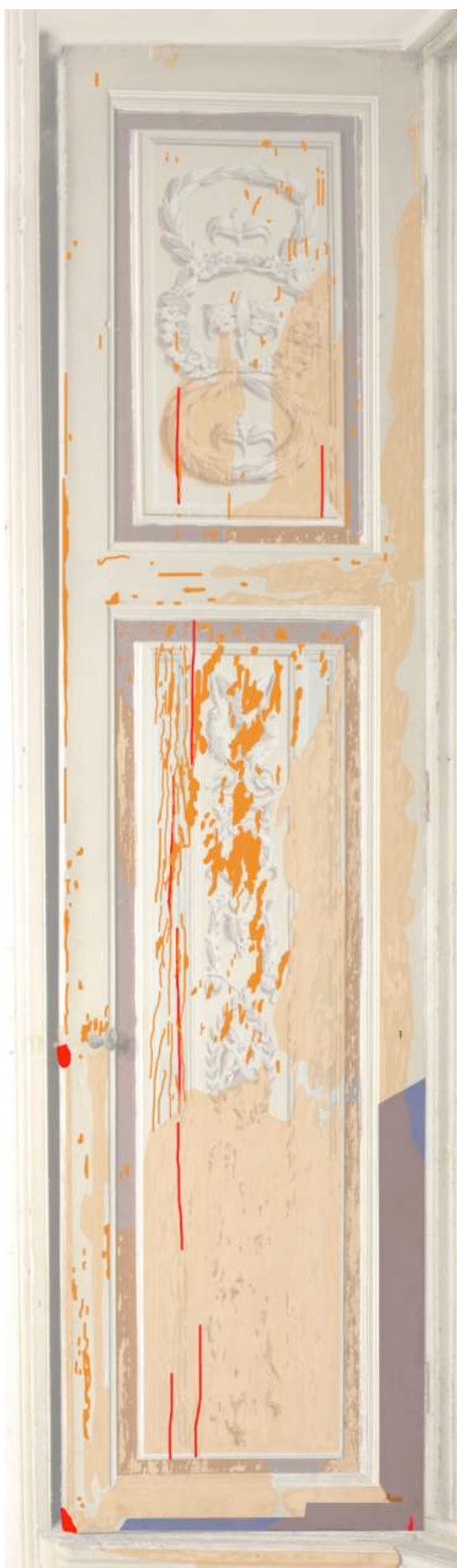
Abb. 188 Kartierung: Scherbenzimmer, Fenster Südseite, Fensterladen, Vorderseite, links
