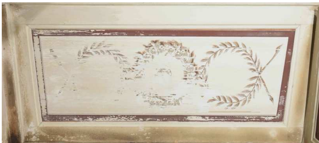
Abb. 148 Scherbenzimmer, linkes Fenster Westseite, Sturz
