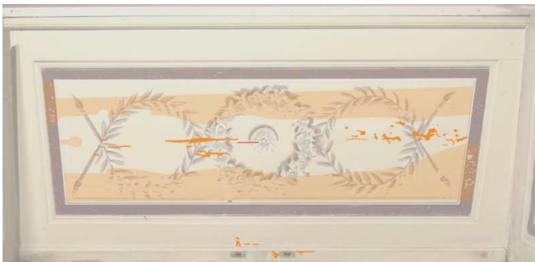
Abb. 193 Kartierung: Scherbenzimmer, Fenster Südseite, Sturz
