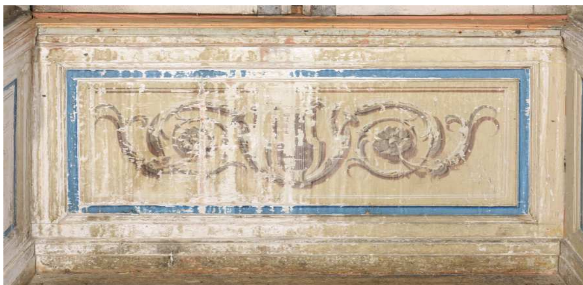
Abb. 140 Scherbenzimmer, rechtes Fenster Westseite, Sockel, Mitte
