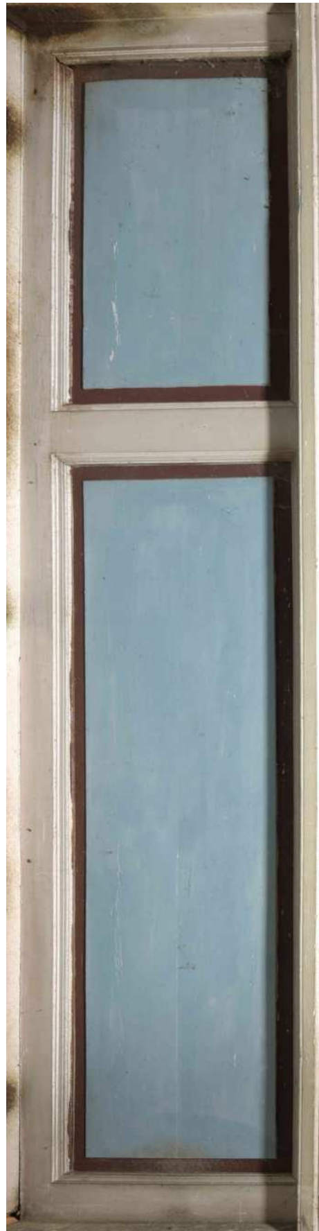
Abb. 147 Scherbenzimmer, linkes Fenster Westseite, Laibung, rechts
