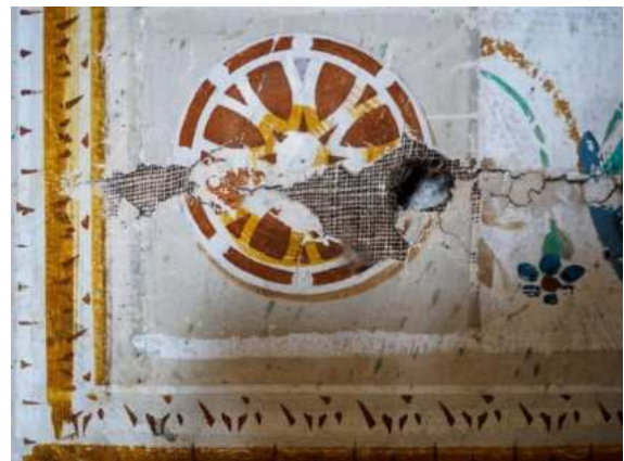
Abb. 50: Abgerissenes Papier (Westwand)
