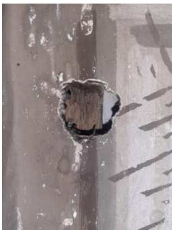
Abb. 47: Mäuseloch, knapp unter der Decke im Nord-West-Ecke
