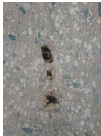
Abb. 48: Nagelloch an der Nordwand
