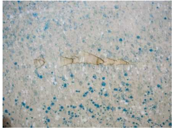
Abb. 54: mechanische Beschädigung (Ostwand)
