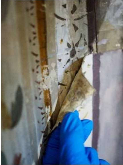
Abb. 60 Malschichtverlust aufgrund des Flickens
