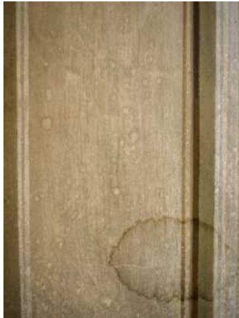
Abb. 56: Wasserfleck und fehlende Malschicht im Bereich des Wasserschadens
