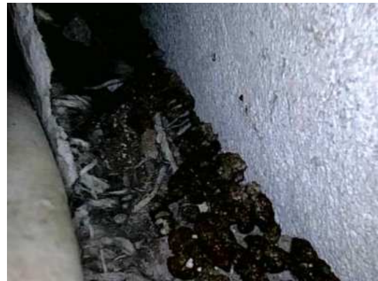
Abb. 45: Mäuseexkremente zwischen der Wand und der Tapete
