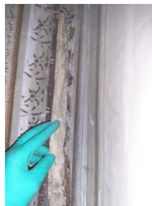
Abb. 52: Teil der originalen Tapete löst sich ab (Nord-Ost-Eck)
